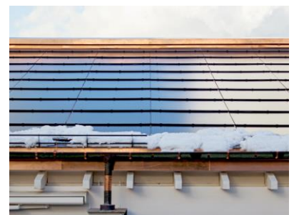
Die alte Dachrinne wird weiterverwendet. Abschmelzen des Schnees durch die thermische Solaranlage des Solardachs.
