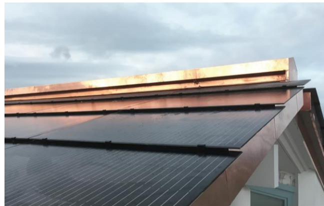
Detailansicht des BS2 Solardachs mit integrierten PVT-Hybridkollektoren (Patent: BS2 AG)
