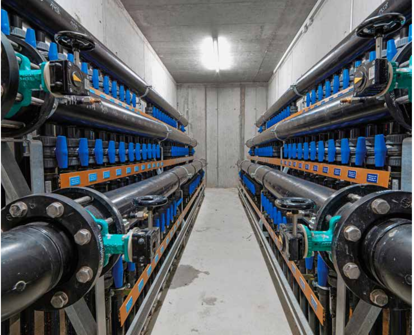
Anergiezentrale der «Suurstoffi» Rotkreuz ZG: Auch auf diese Weise lässt sich das Erdreich als Wärmespeicher nutzen, und die Energien können nach dem effektiven LowEx-Prinzip auf die einzelnen Verbraucher verteilt werden.
